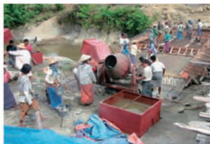
マウンドーでの橋梁建設の様子。女性もOJTに参加 写真提供:ブリッジ エーシア ジャパン
